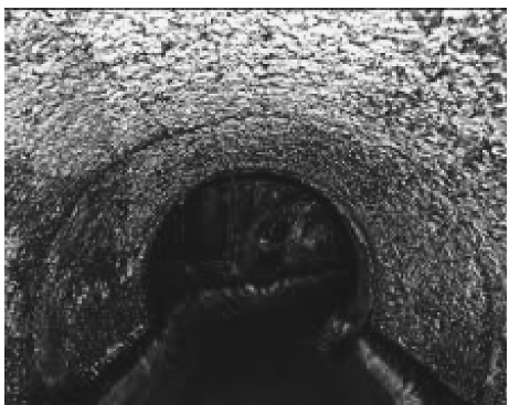
腐食で緊急度Ⅰと判定された下水道管
