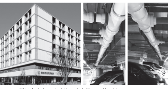
横浜市立市民病院地下駐車場の天井配管(100A~300A)
