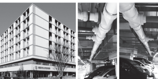
横浜市立市民病院地下駐車場の天井配管(100A~300A)
