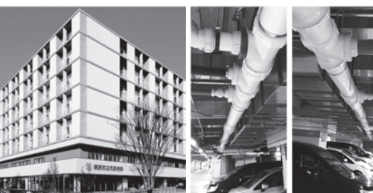
横浜市民病院内地下駐車場の天井配管(100A~300A)
